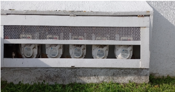
Contador de Gas
