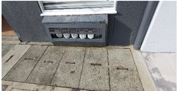
Contador de Agua
