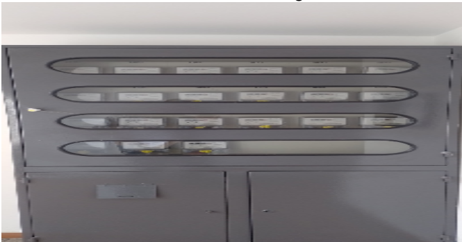
Contador de Energia
