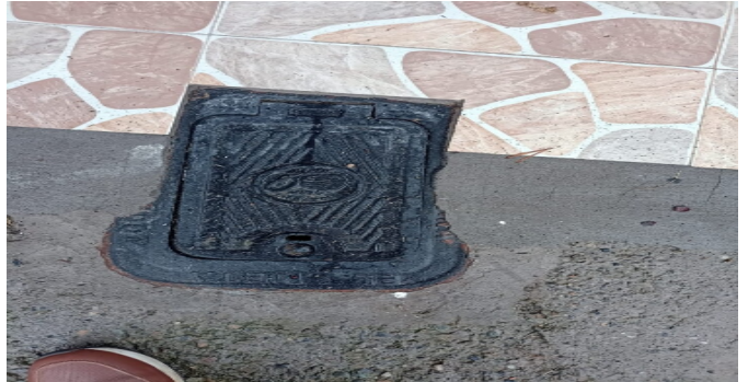
Contador de Agua
