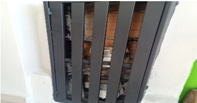
Contador de Gas
