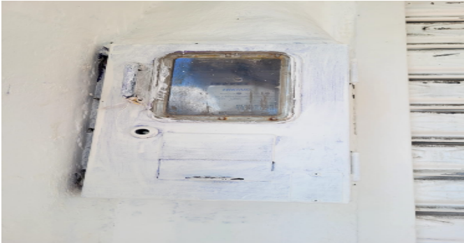
Contador de Energia
