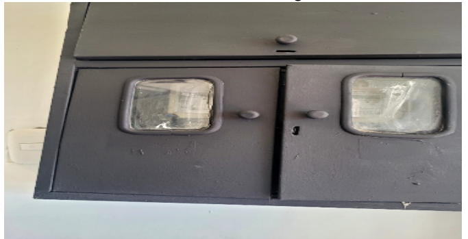
Contador de Energia
