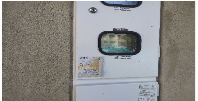
Contador de Energia
