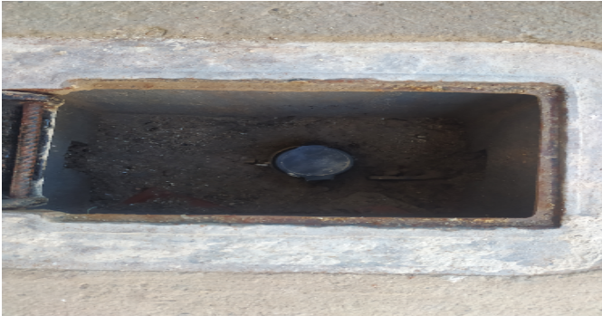
Contador de Agua
