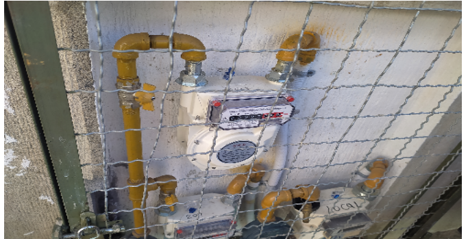
Contador de Gas
