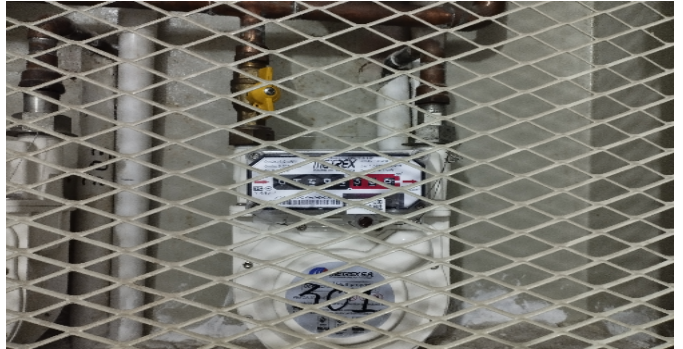
Contador de Gas
