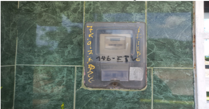
Contador de Energia
