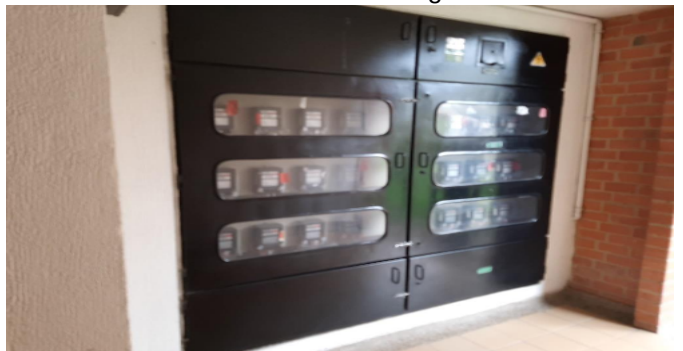
Contador de Energia
