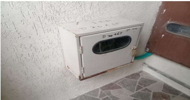
Contador de Gas
