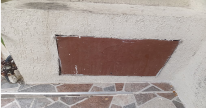
Contador de Agua
