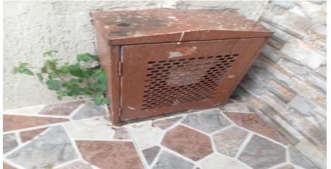
Contador de Gas
