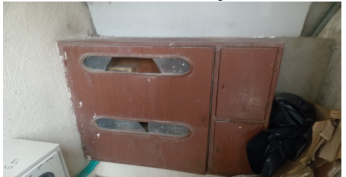
Contador de Energia
