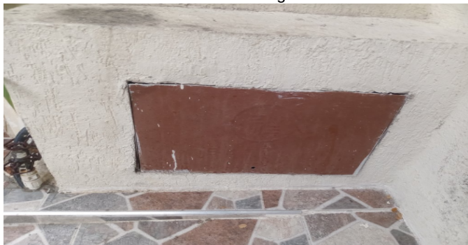
Contador de Agua
