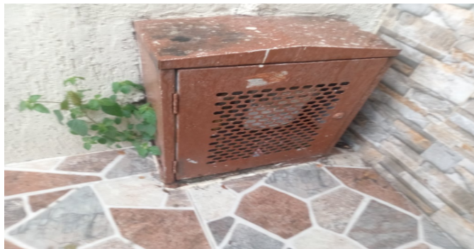
Contador de Gas
