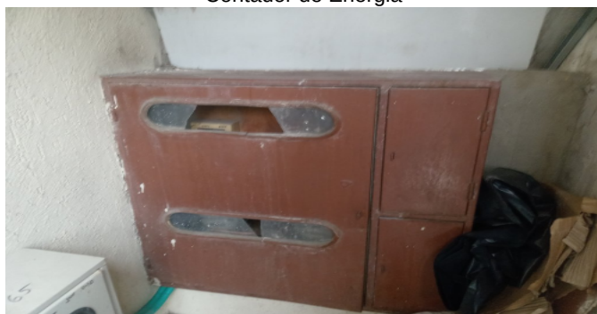
Contador de Energia
