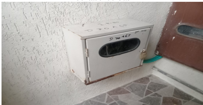
Contador de Gas
