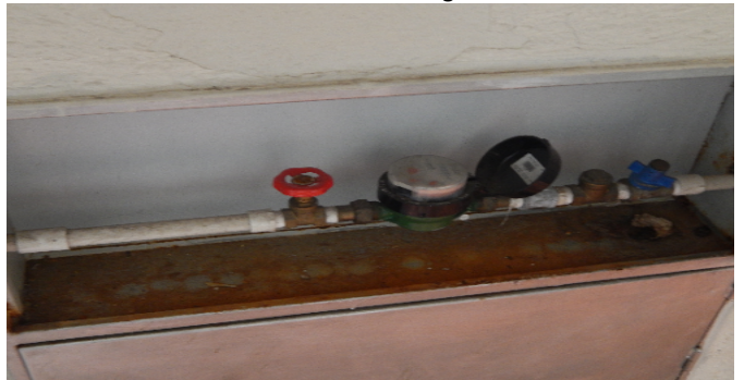
Contador de Agua
