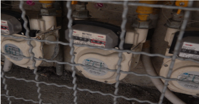
Contador de Gas
