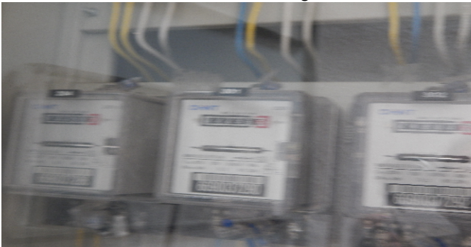
Contador de Energia
