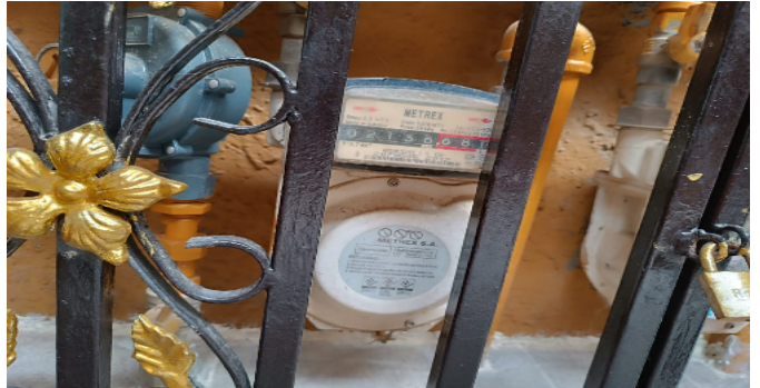
Contador de Gas
