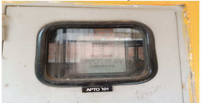
Contador de Energia
