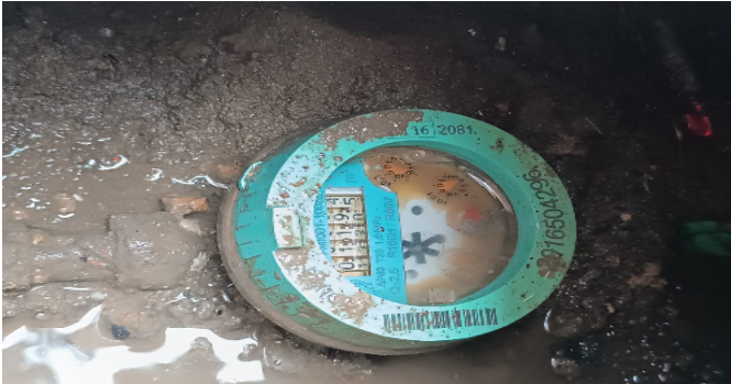
Contador de Agua
