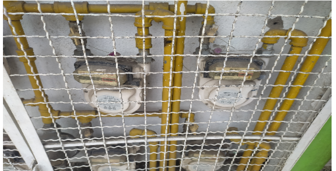
Contador de Gas
