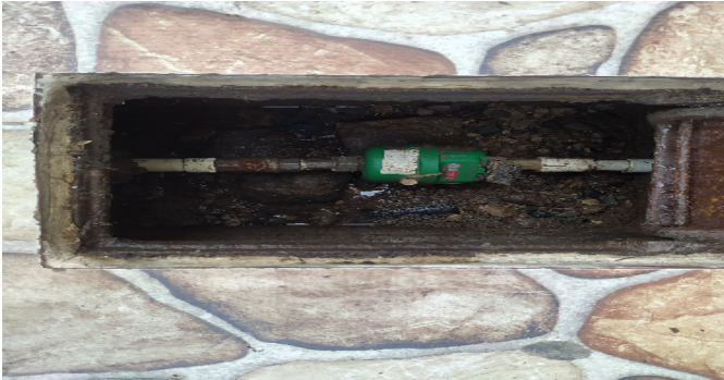
Contador de Agua
