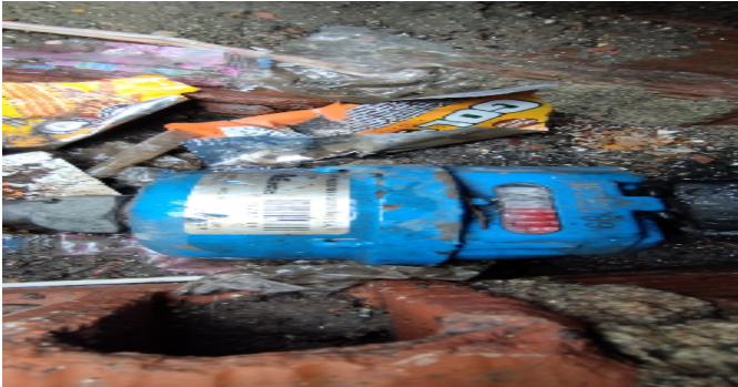
Contador de Agua
