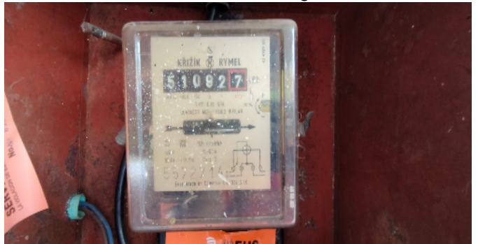
Contador de Energia
