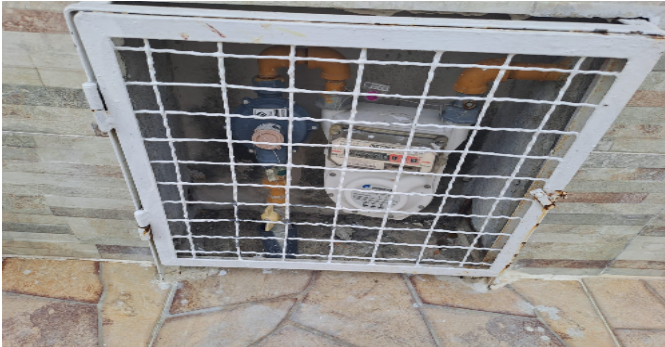
Contador de Gas
