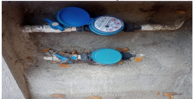
Contador de Agua
