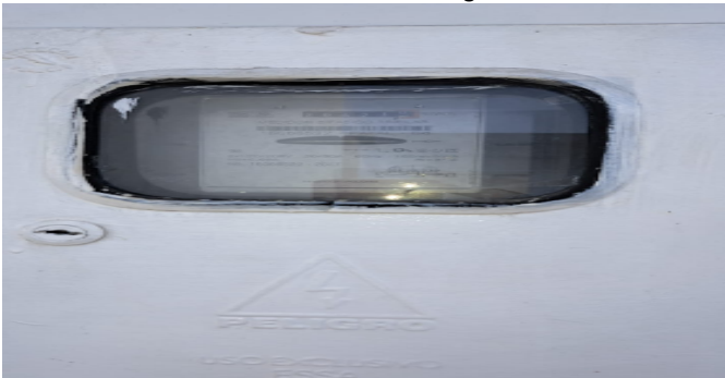
Contador de Energia
