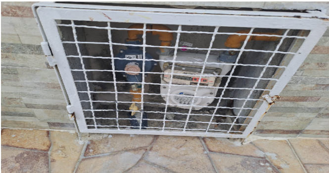
Contador de Gas
