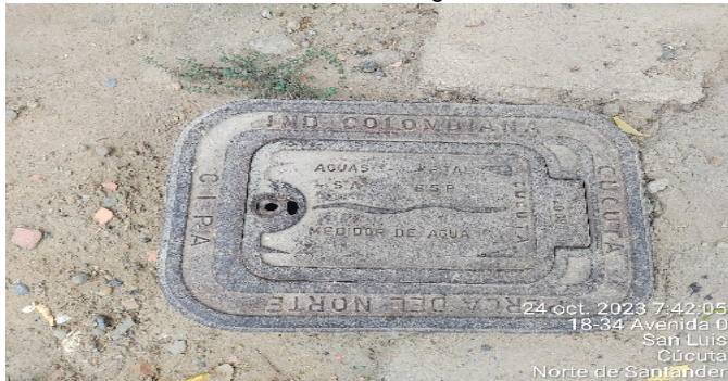
Contador de Agua
