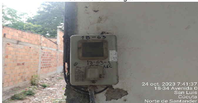
Contador de Energia
