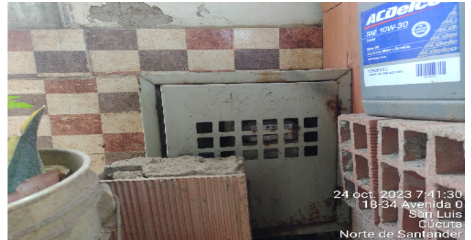
Contador de Gas
