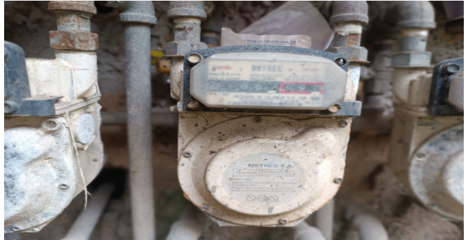
Contador de Gas
