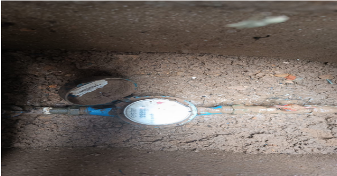
Contador de Agua
