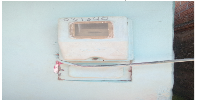
Contador de Energia
