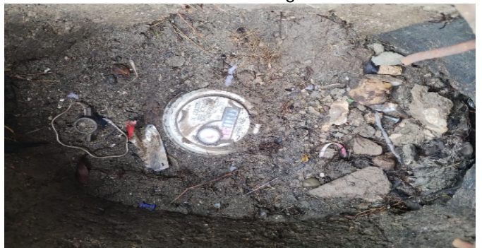
Contador de Agua
