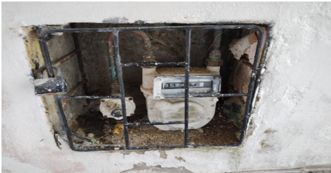
Contador de Gas
