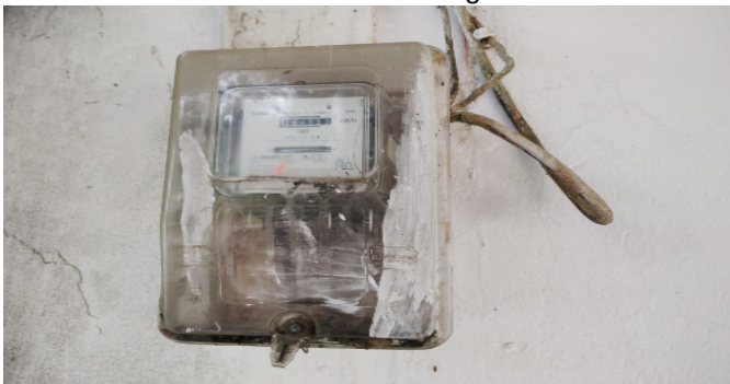
Contador de Energia
