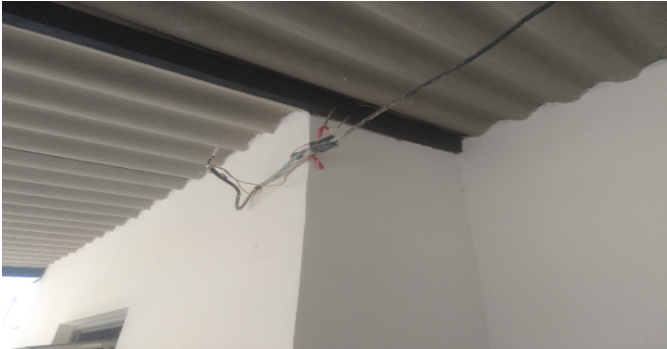
Contador de Energia
