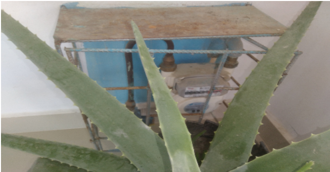
Contador de Gas
