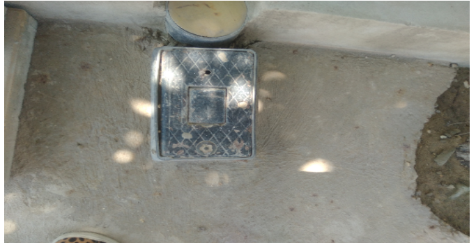
Contador de Agua
