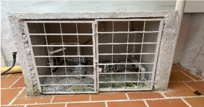
Contador de Agua
