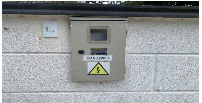
Contador de Energia
