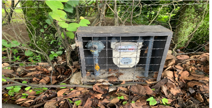
Contador de Gas
