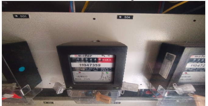
Contador de Energia
