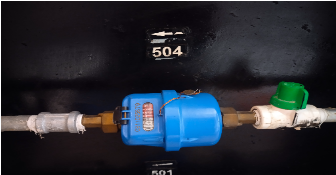
Contador de Agua
