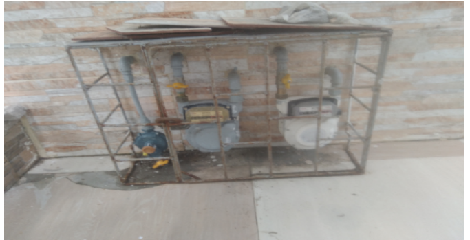
Contador de Gas
