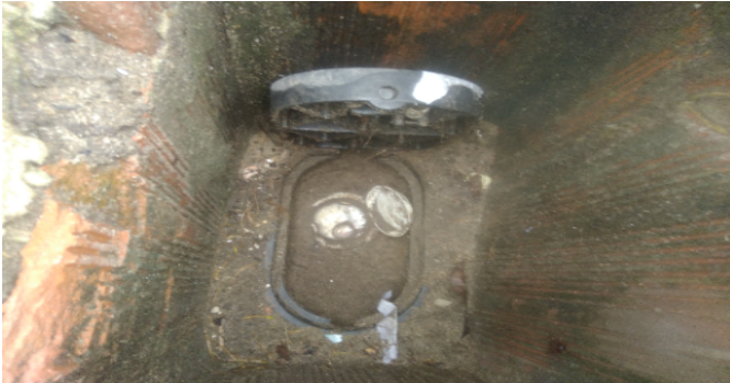
Contador de Agua
