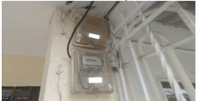
Contador de Energia
