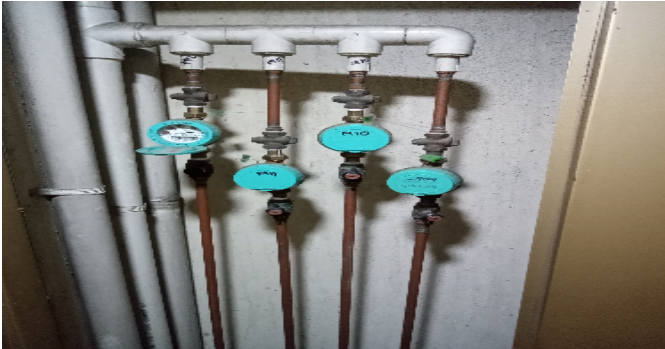
Contador de Agua
