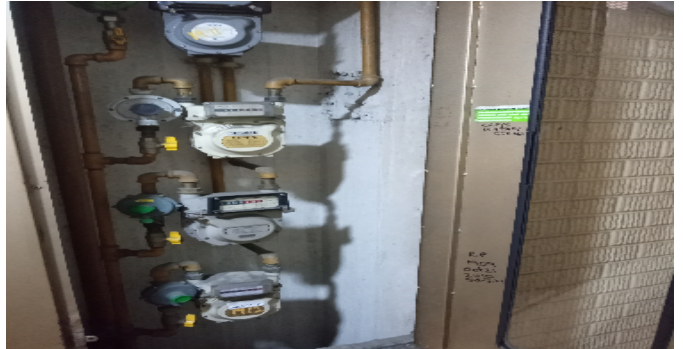
Contador de Gas
