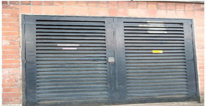
Contador de Energia
