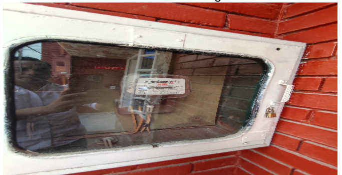
Contador de Energia
