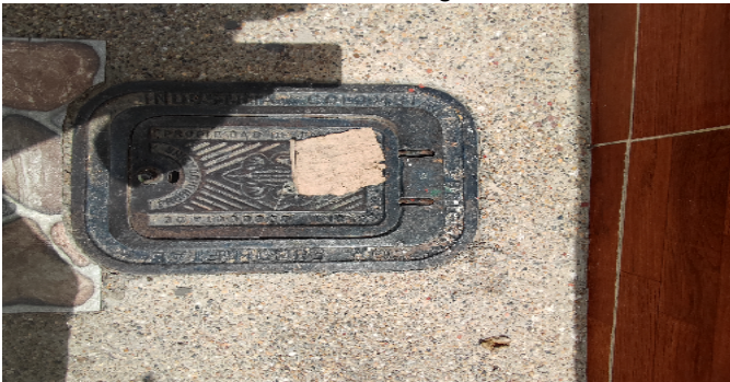
Contador de Agua
