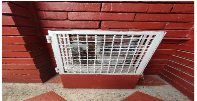
Contador de Gas
