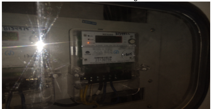
Contador de Energia
