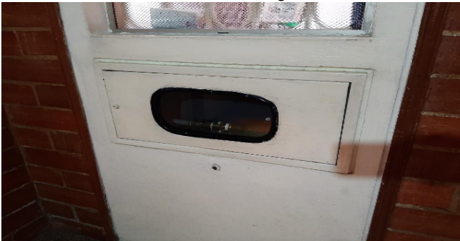
Contador de Agua
