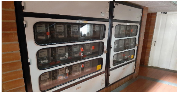
Contador de Energia
