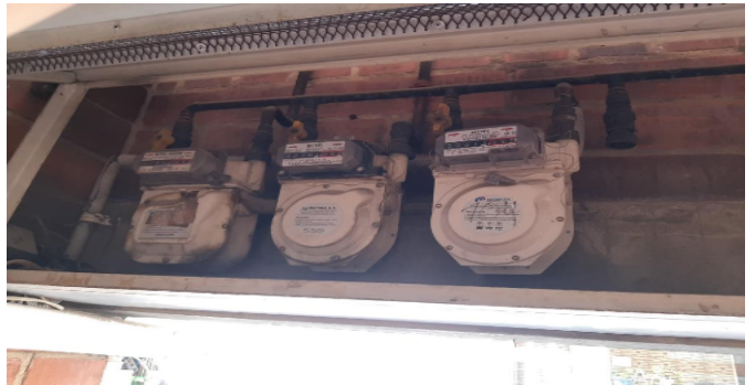
Contador de Gas
