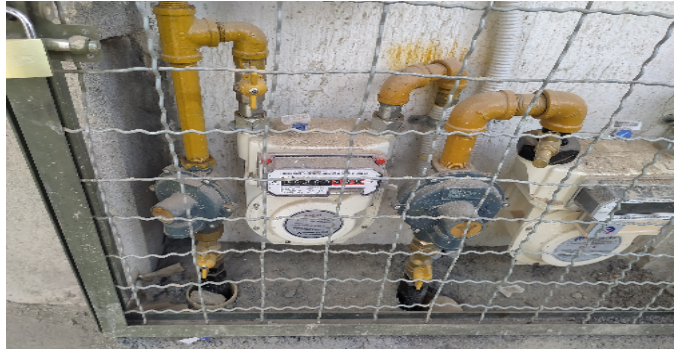
Contador de Gas
