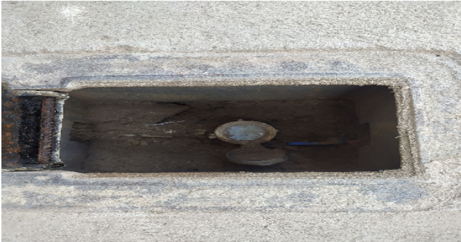
Contador de Agua
