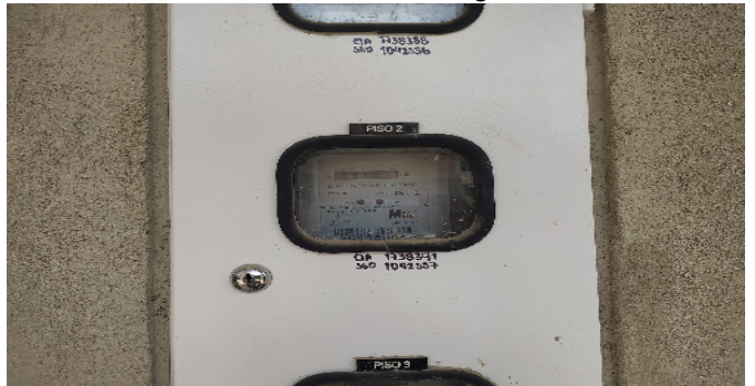
Contador de Energia
