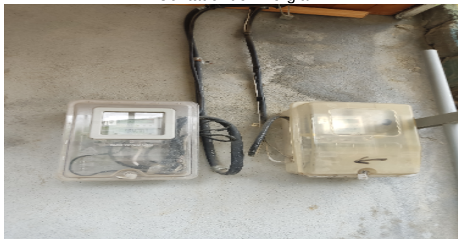
Contador de Energia
