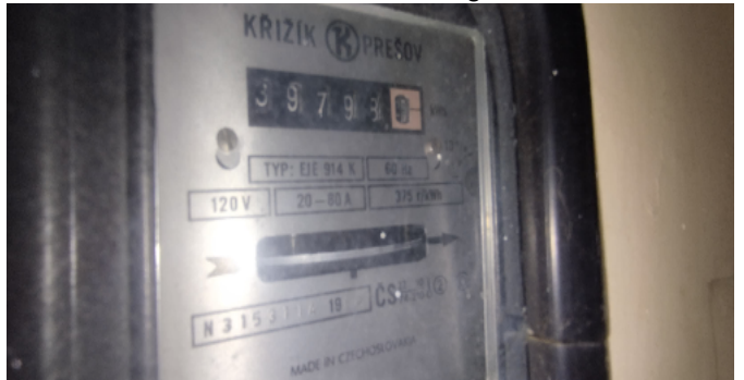
Contador de Energia
