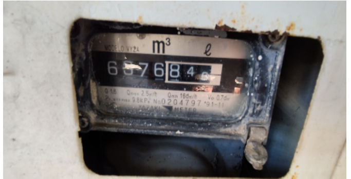
Contador de Gas
