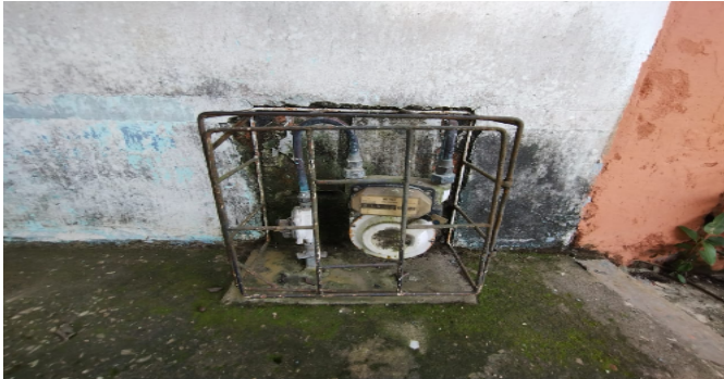
Contador de Gas
