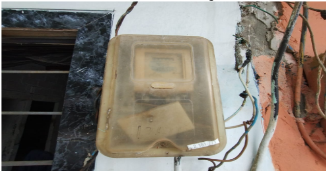
Contador de Energia
