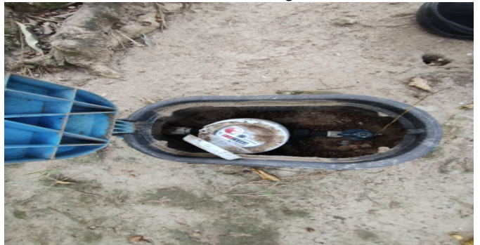
Contador de Agua
