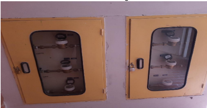
Contador de Agua
