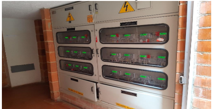
Contador de Energia
