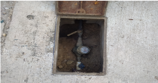
Contador de Agua
