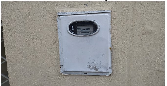
Contador de Energia
