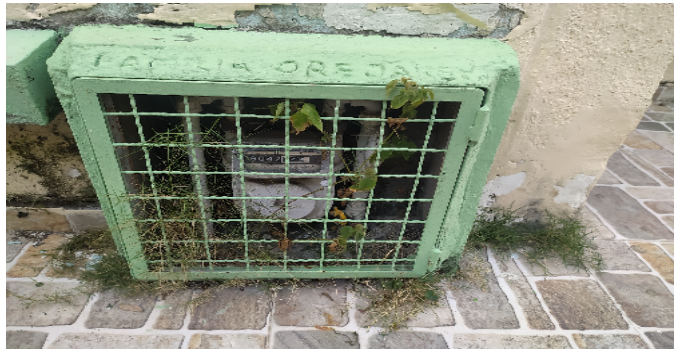
Contador de Gas
