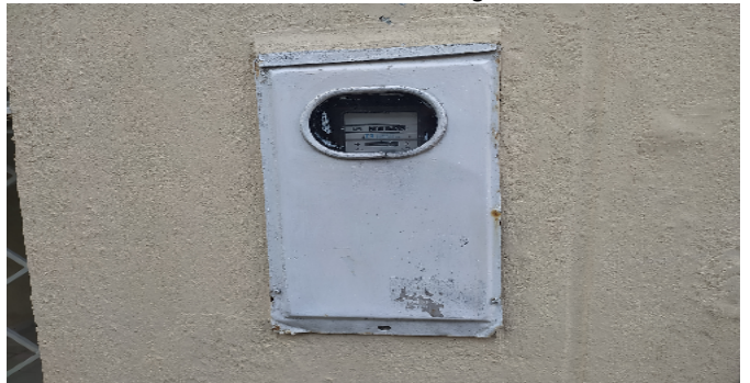
Contador de Energia
