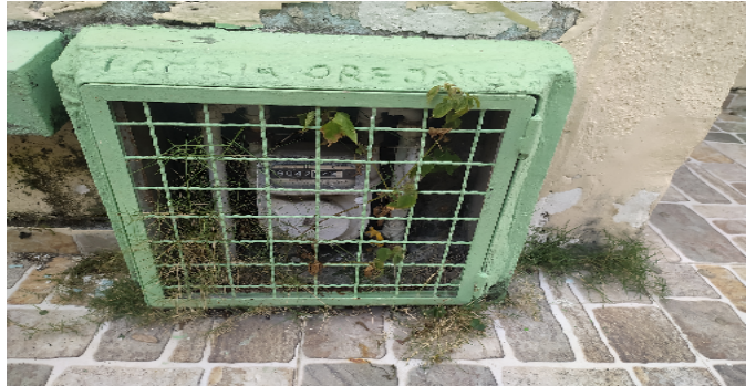
Contador de Gas
