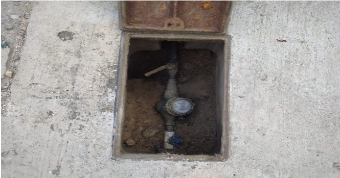
Contador de Agua
