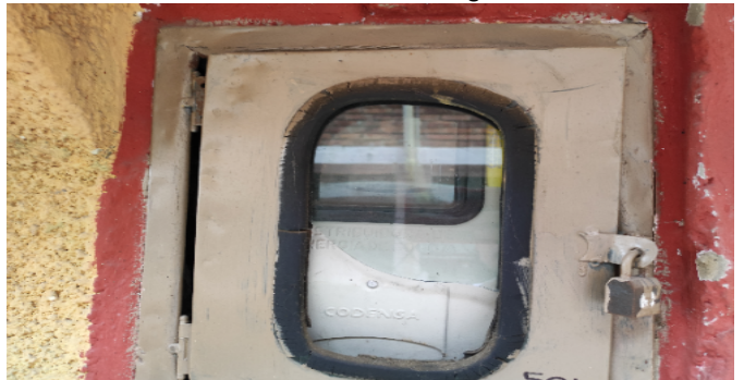
Contador de Energia
