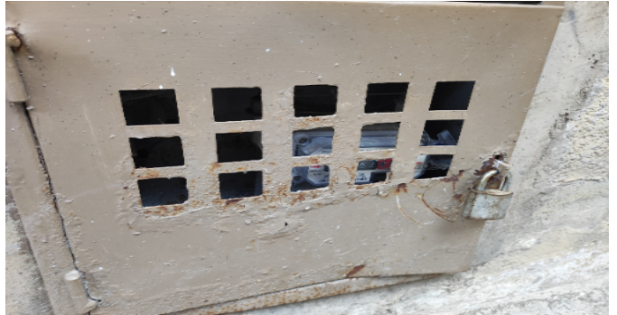
Contador de Gas
