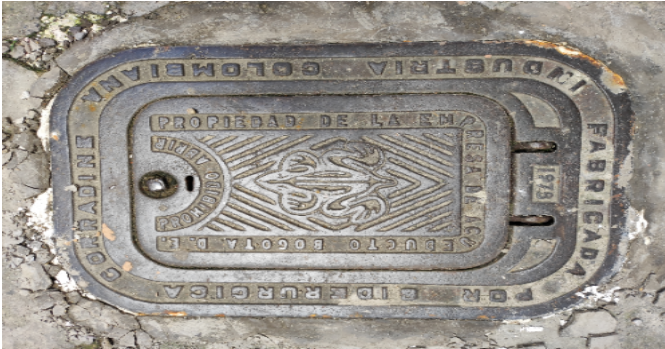
Contador de Agua
