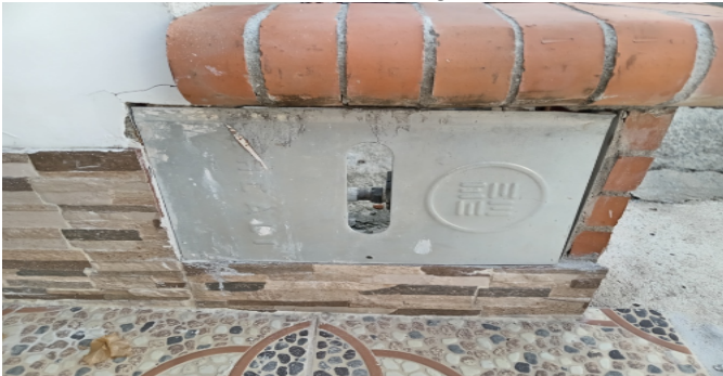
Contador de Agua
