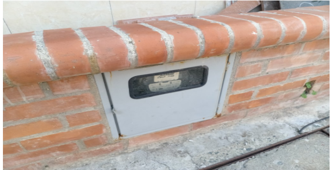
Contador de Energia
