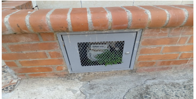
Contador de Gas
