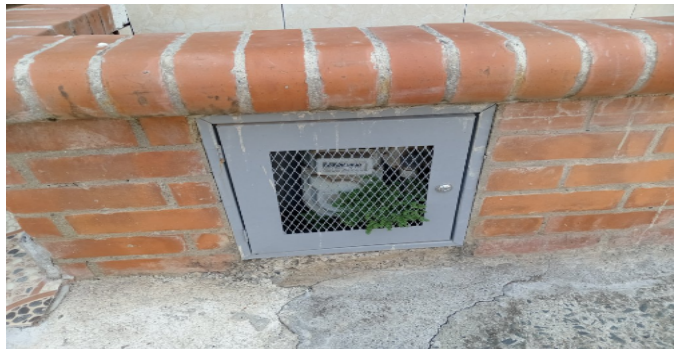
Contador de Gas
