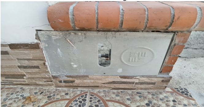
Contador de Agua
