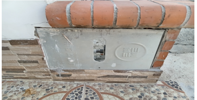
Contador de Agua
