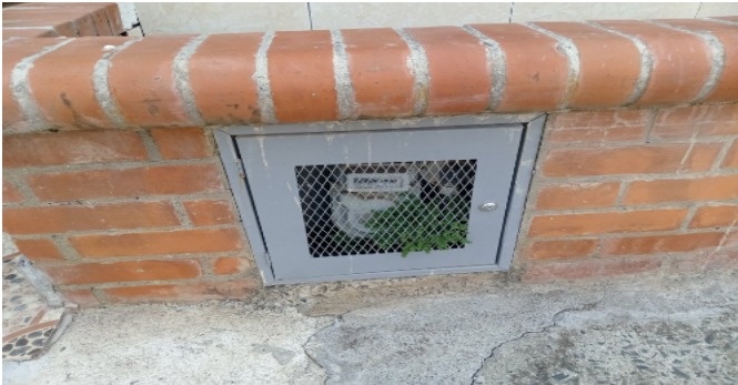
Contador de Gas
