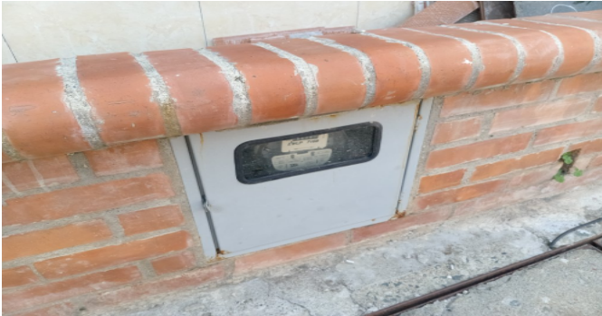
Contador de Energia
