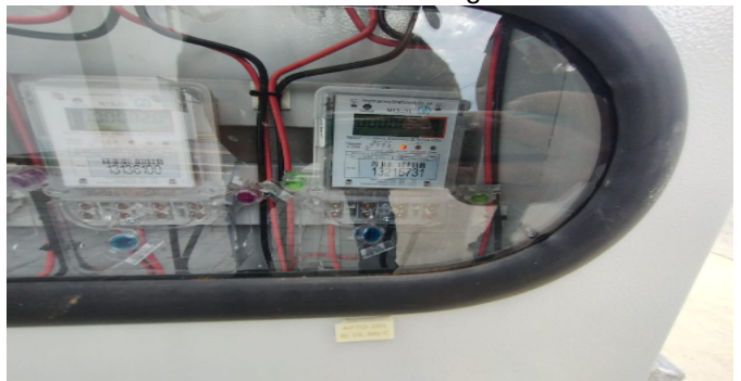
Contador de Energia
