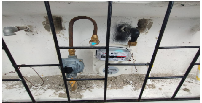
Contador de Gas
