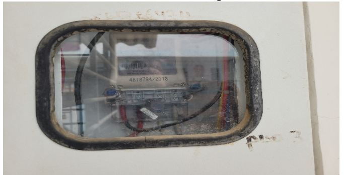
Contador de Energia
