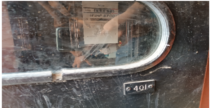
Contador de Energia
