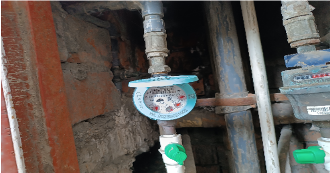
Contador de Agua
