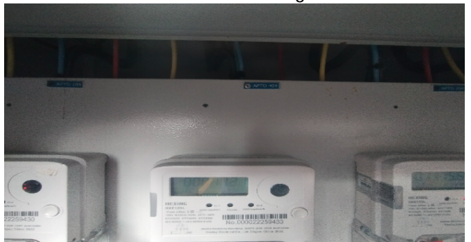
Contador de Energia
