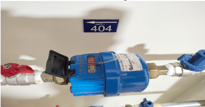
Contador de Agua
