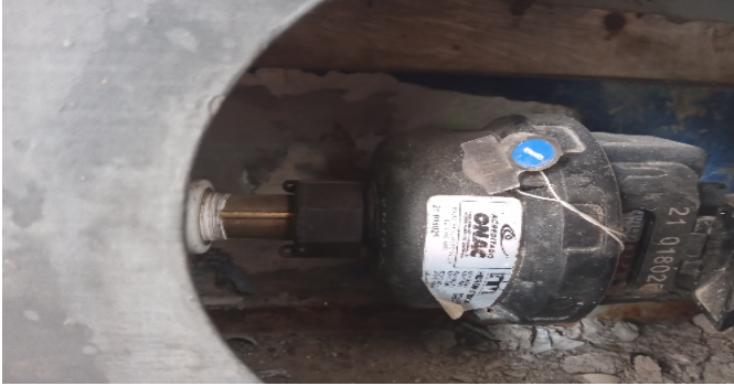
Contador de Agua
