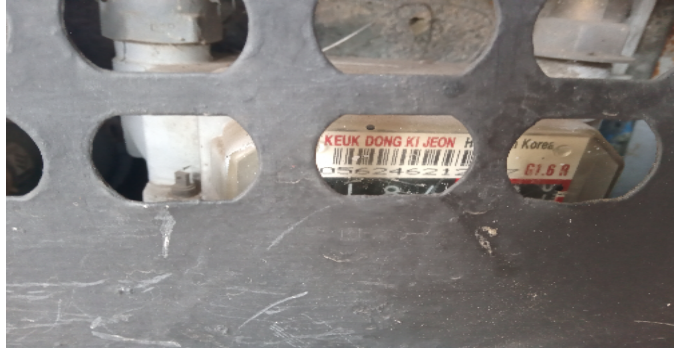
Contador de Gas
