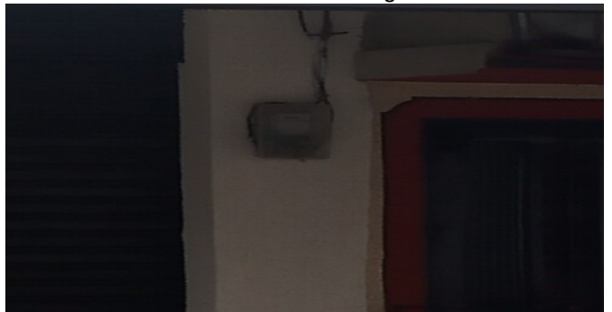
Contador de Energia
