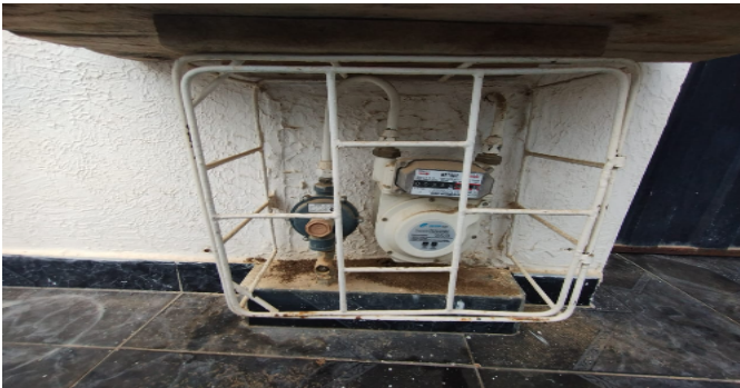
Contador de Gas
