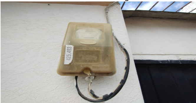
Contador de Energia
