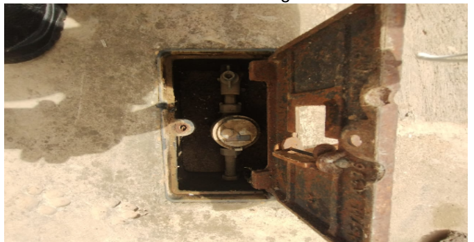
Contador de Agua
