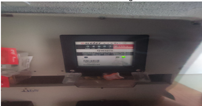
Contador de Energia
