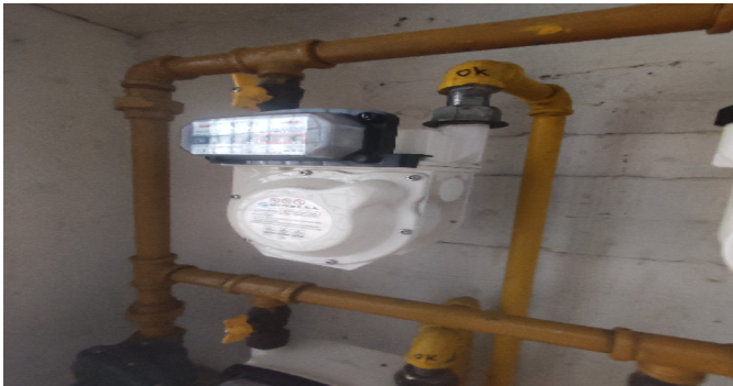
Contador de Gas
