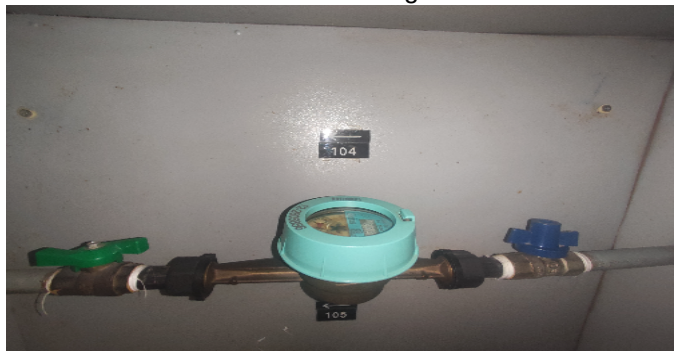
Contador de Agua
