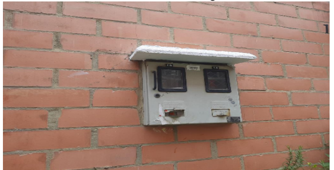
Contador de Energia
