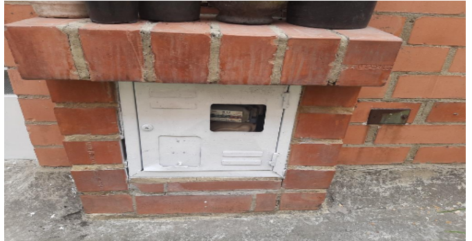
Contador de Gas
