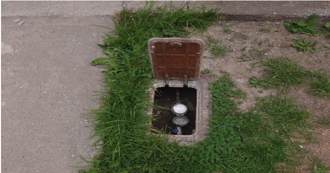
Contador de Agua
