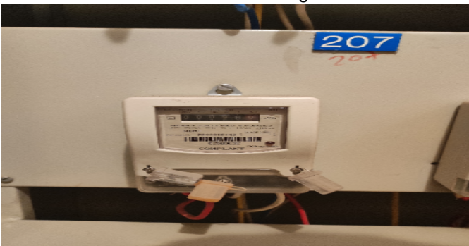
Contador de Energia
