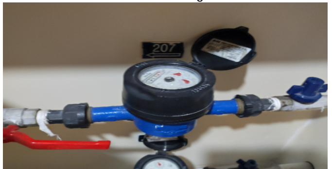
Contador de Agua
