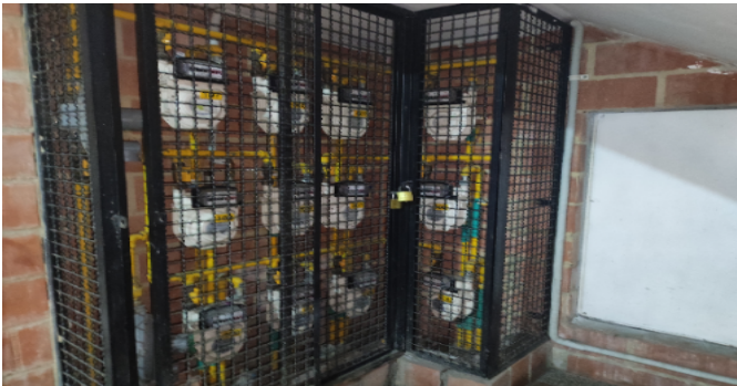
Contador de Gas
