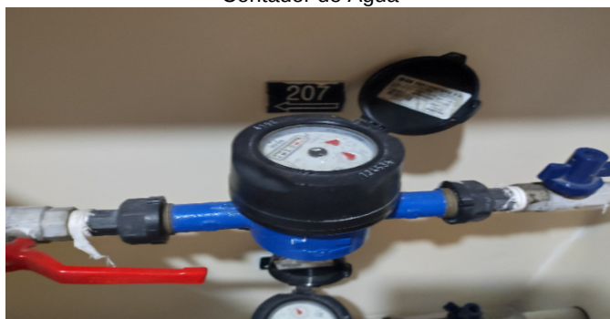
Contador de Agua
