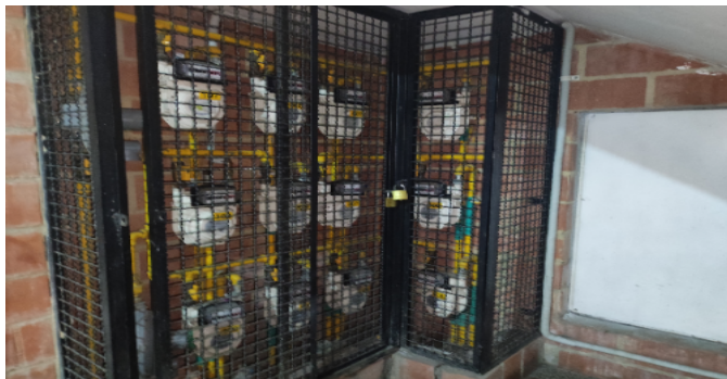
Contador de Gas
