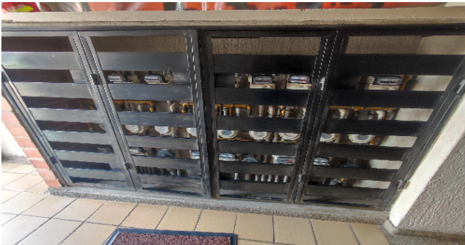
Contador de Gas
