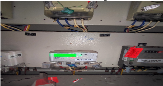
Contador de Energia
