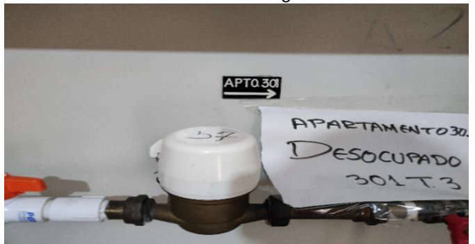
Contador de Agua
